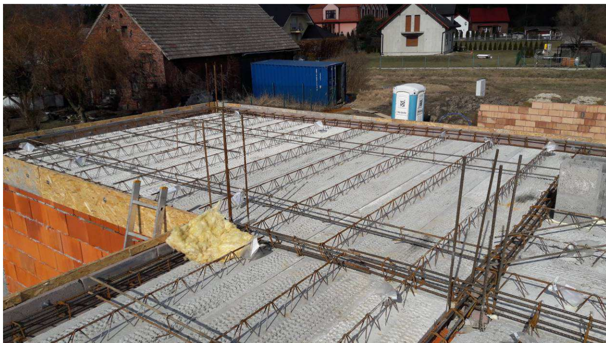
Rys. 40. Żebra rozdzielcze ułożone na prefabrykatach stropu Vector Fig. 40. Distribution ribs arranged on the precast slab of Vector ceiling
