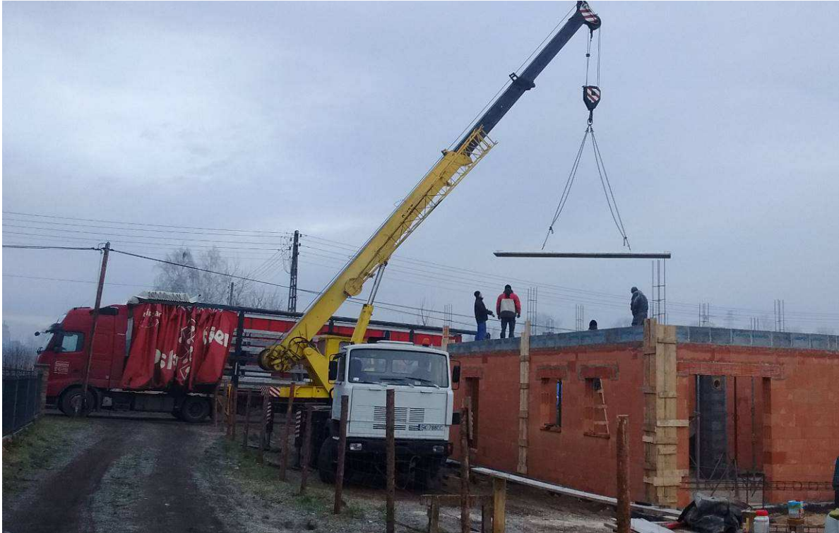
Rys. 23. Montaż płyt stropu Vector za pomocą żurawia samojezdnego Fig. 23. Installation of Vector slab using a self-propelled crane
