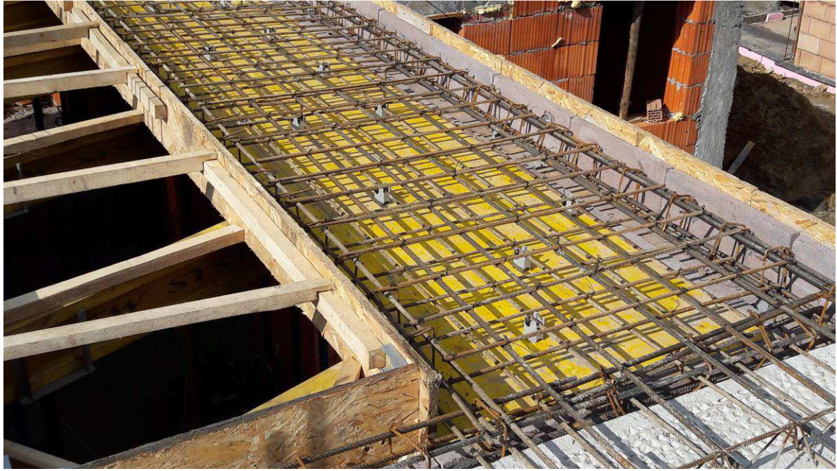
Rys. 62. Przykład połączenia płyty monolitycznej ze stropem Vector Fig. 64. An example of connection of a monolithic slab with a Vector ceiling
