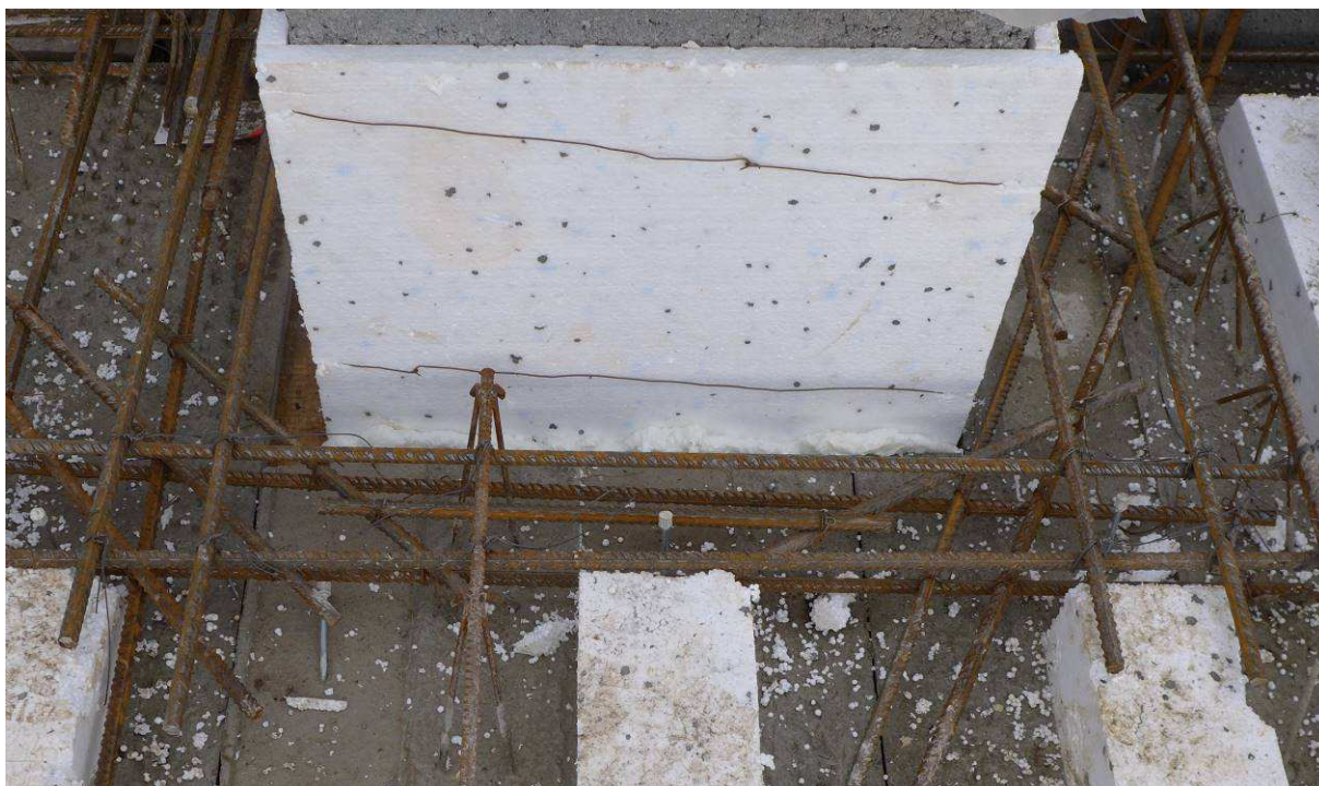
Rys. 59. Otwór wymagający dobrojenia Fig. 61. A hole requiring additional reinforcement
