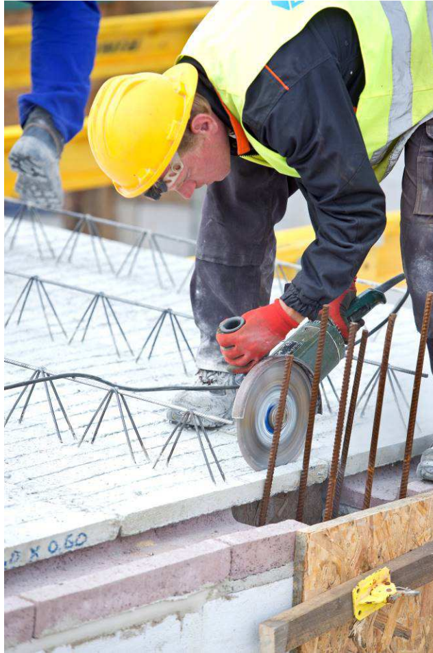
Rys. 57. Wycinanie otworu za pomocą szlifierki kątowej Fig. 59. Cutting the hole using an angle grinder
