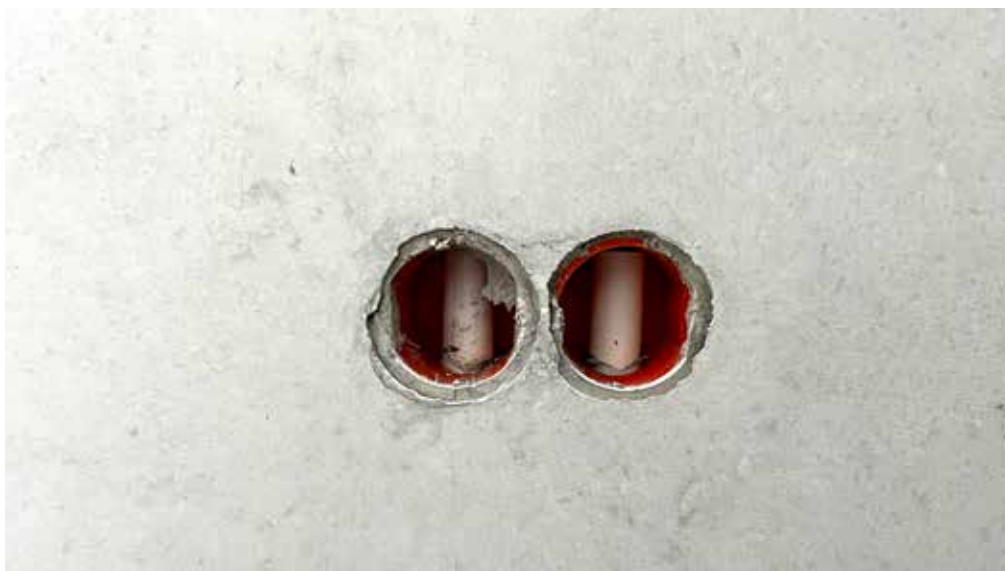
Puszki elektryczne zatopione w ścianie
