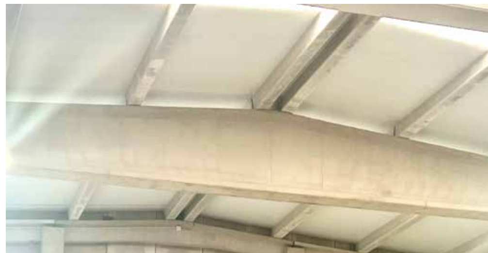
Dźwigary dachowe zastosowane w konstrukcji hali produkcyjnej
